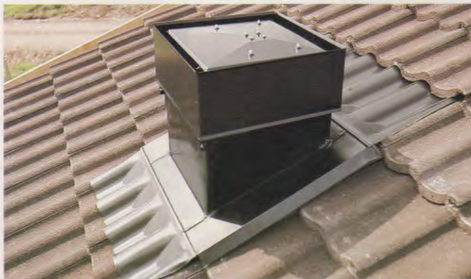
En central fläkt på taket sköter ventilationen i hela huset.
